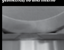
Encosto do anel interno fraturada
