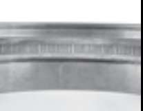
Cratères d'arcs électriques
