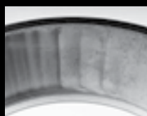
Urme de surfilare pe calea de rulare a inelului exterior cauzate de jocul axial excesiv
