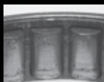
Exfoliere cauzată de oboseală datorată încărcărilor mari
